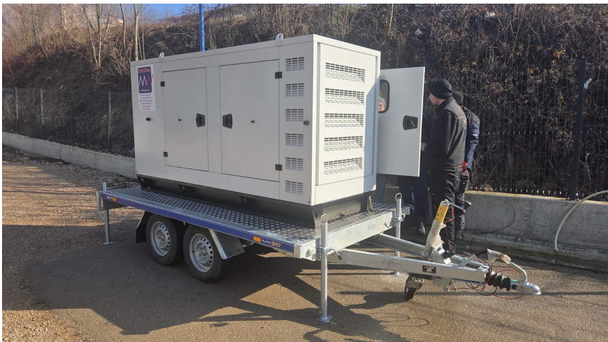
Slika 12. Mobilni agregat 80 kVA/64 kW trajne snage
