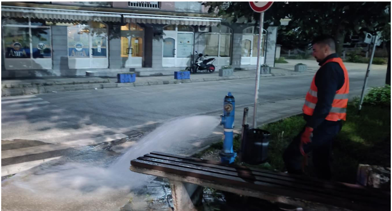
Slika 8. Redovno ispiranje vodovodne mreže
